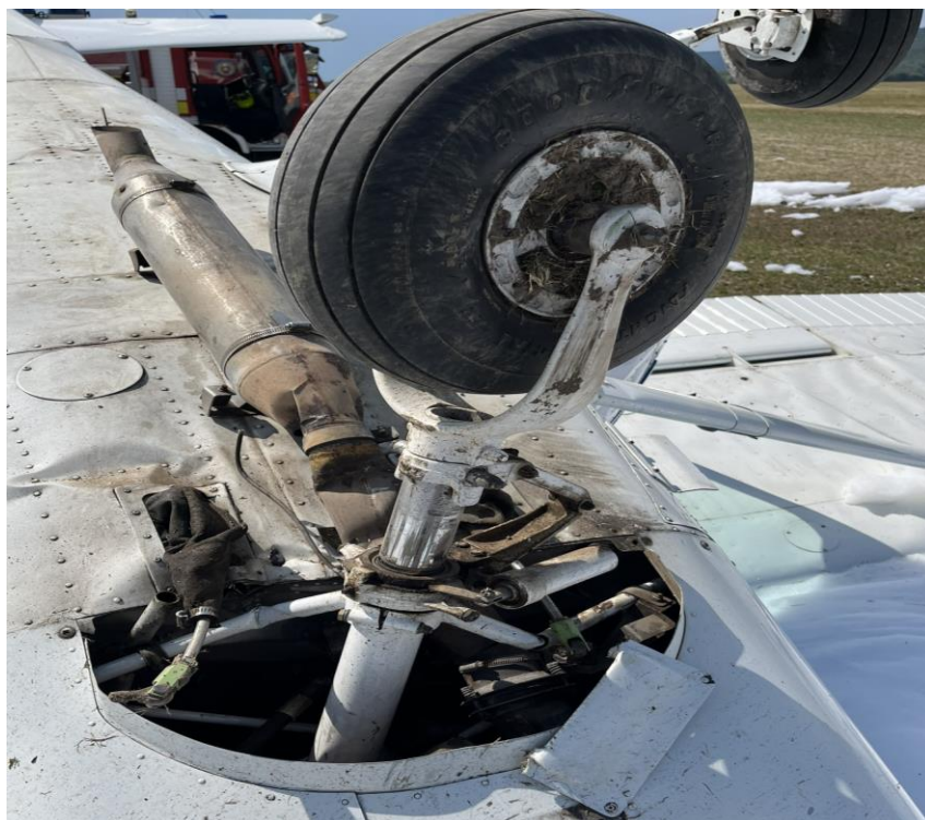
Obr. č. 10 stav prednej podvozkovej nohy
