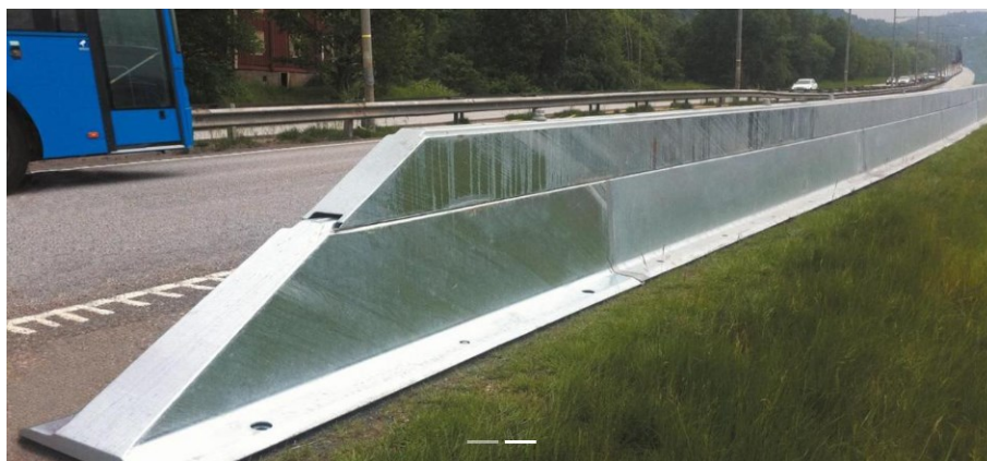
Obrázok 10: Pohľad na zvodidlo Duo Rail KA
